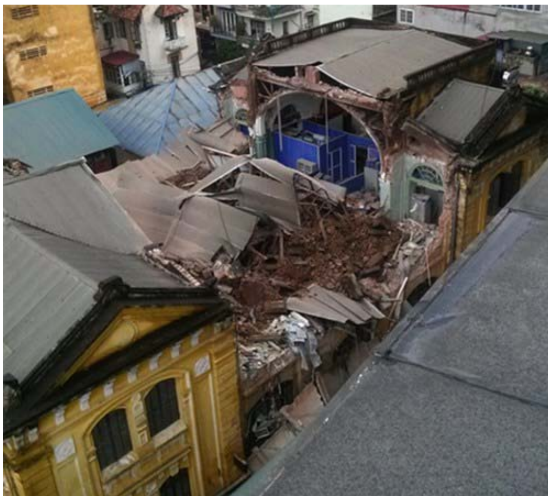
Nhà cổ sập hôm 23/9/2015.
